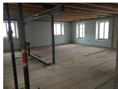
Rez supérieur. Ancien bureau communal et bureau d'archives qui deviendra l'appartement n° 1 en duplex
